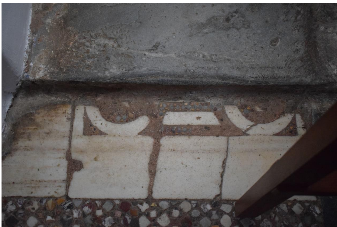
Εικ. 68: Μονή Σαγματά, λιτή, νότια είσοδος προς τον κυρίως ναό, τμήμα πλάκας με κατάλοιπα σύνθεσης με ομφάλια.
