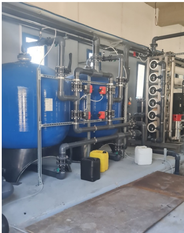
Σχήμα 2.7: Η νέα μονάδα αφαλάτωσης στο Δ. Νισύρου.
