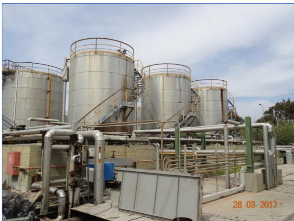
Εικόνα 33: Άποψη Τριών Δεξαμενών Ημερήσιας Κατανάλωσης (Δ.Η.Κ.) Μαζούτ.
