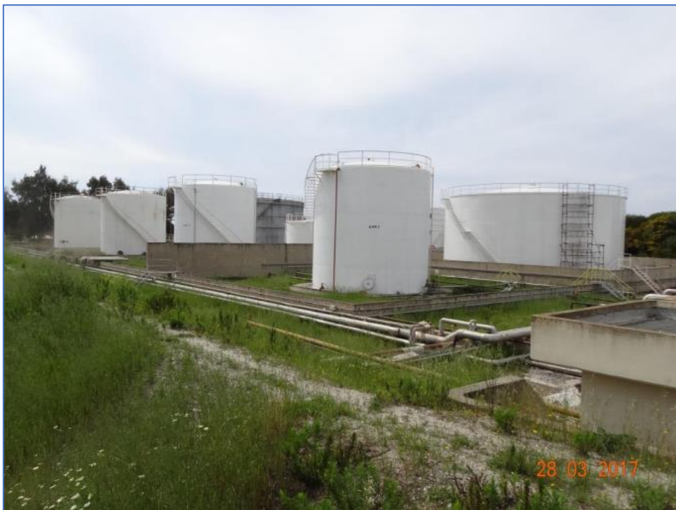
Εικόνα 31: Αποψη δεξαμενών Ντίζελ.
