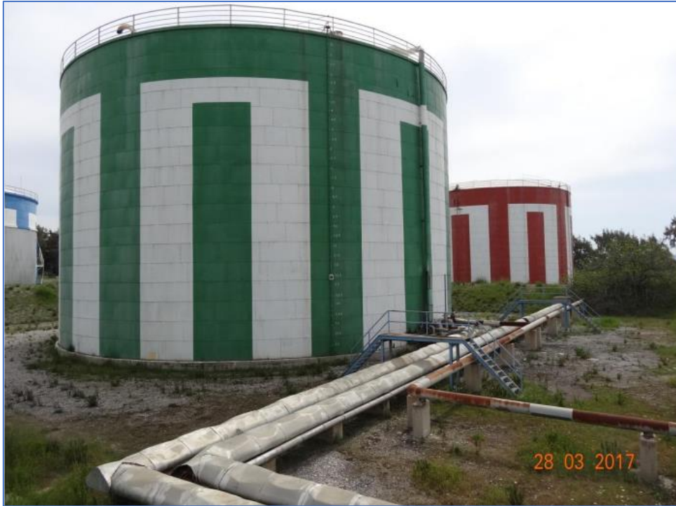
Εικόνα 30: Δεξαμενές αποθήκευσης Ντίζελ. Στα αριστερά (με κυανόλευκο χρώμα) διακρίνεται και μία δεξαμενή αποθήκευσης Μαζούτ.
