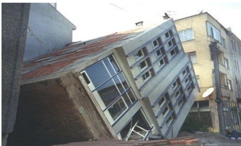
Εικόνα 4. Ανατροπή κτιρίου στο Ανταπαζάρι (Adapazari) λόγω εξασθενημένων θεμελίων.
