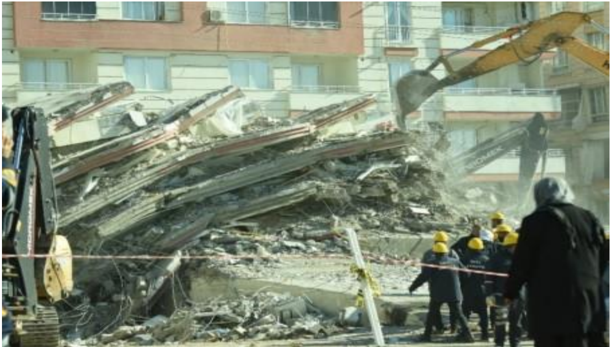
Εικόνα 3.8: Ολική κατάρρευση (Πηγή: Lekkas et al., 2023)
