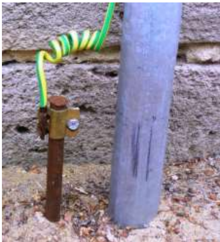
Σχήμα 221 , χάλκινη πλάκα (γείωση) τοποθετημένη στο έδαφος
