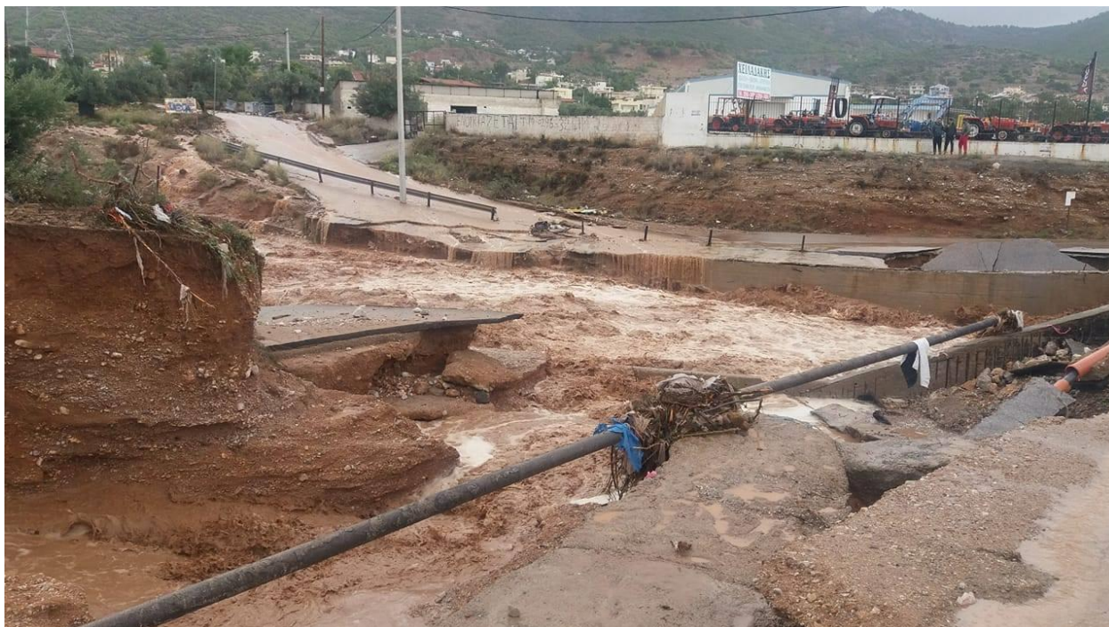
Εικόνα 3.5. Επιπτώσεις των πλημμυρών στη Μάνδρα
