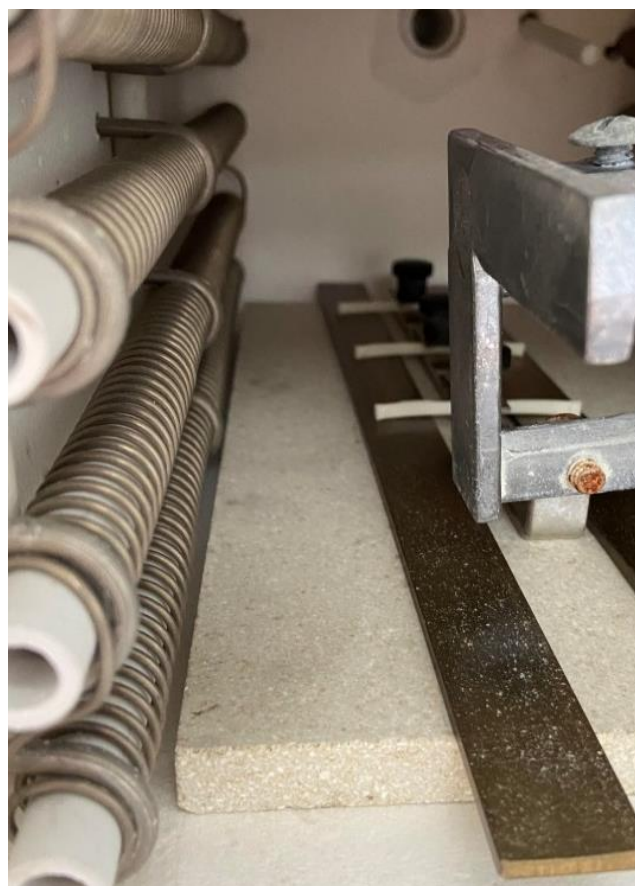
Εικόνα 15 : Αυτοσχέδια κατασκευή μέσα στον φούρνο και πάνω στις λάμες από μπρούτζο
