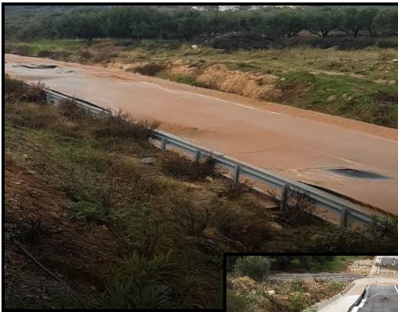
Εικόνα 10.8. Πλημμυρισμένη παράπλευρη οδός του ΒΟΑΚ και καθίζηση λόγω διάβρωσης του οδοστρώματος μετά την πλημμύρα.
