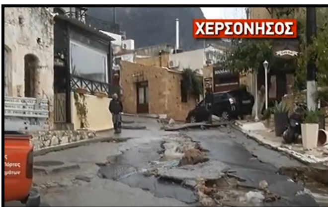
Εικόνα 10.9. Διάβρωση του ασφαλτοτάπητα από τα ορμητικά νερά στην ενδοχώρα του οικισμού Χερσονήσου
