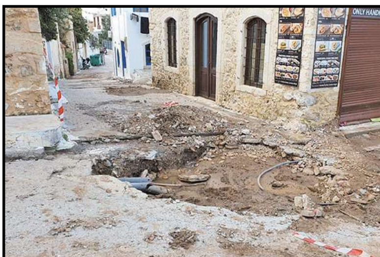
Εικόνα 10.15. Αποψη του ίδιου σημείου στο Κουτουλουφάρι με κατά-στροφή οδοστρώματος και βλάβες σε αγωγούς υδροδότησης και αποχέτευσης σε κεντρικό δρόμο του οικισμού ( https://www.iefimerida.gr/ellada/akokairia-pnigike-xana-i-kriti-se-katastasi-ektaktis-anagkis-dyohoria ).
