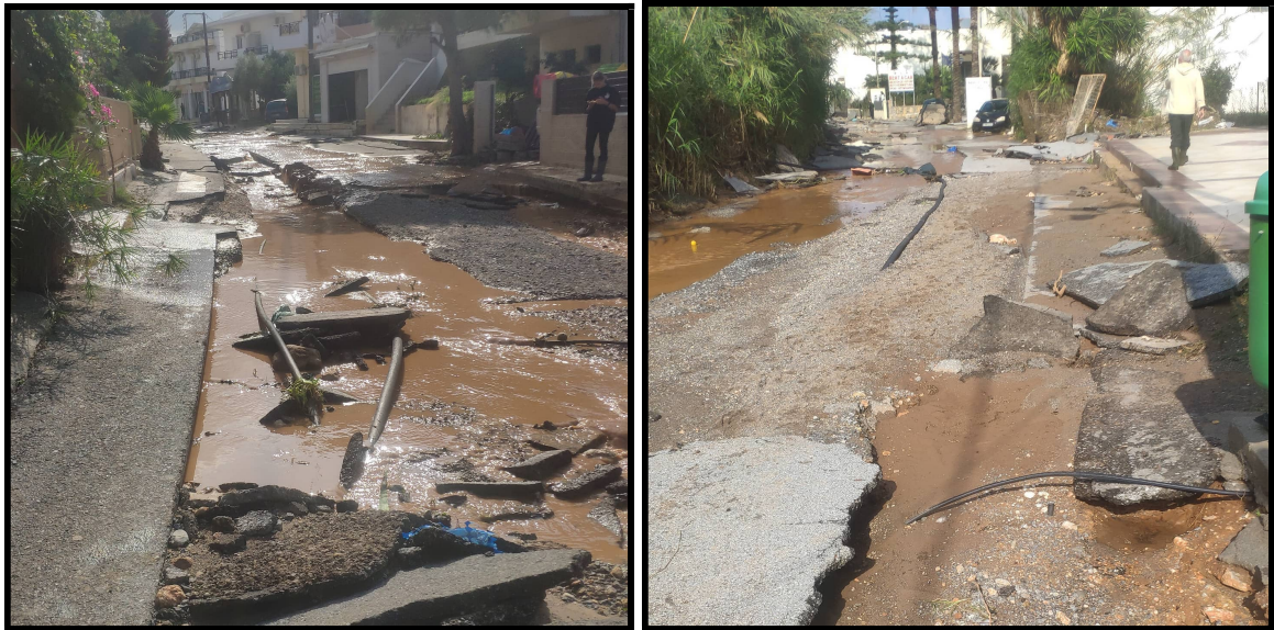
Εικόνα 10.45. Διάβρωση ασφαλτικού τάπητα και ανατροπή του σε σημεία, με εκτεταμένες βλάβες στα δίκτυα κοινής ωφέλειας στην Ανάληψη Χερσονήσου
