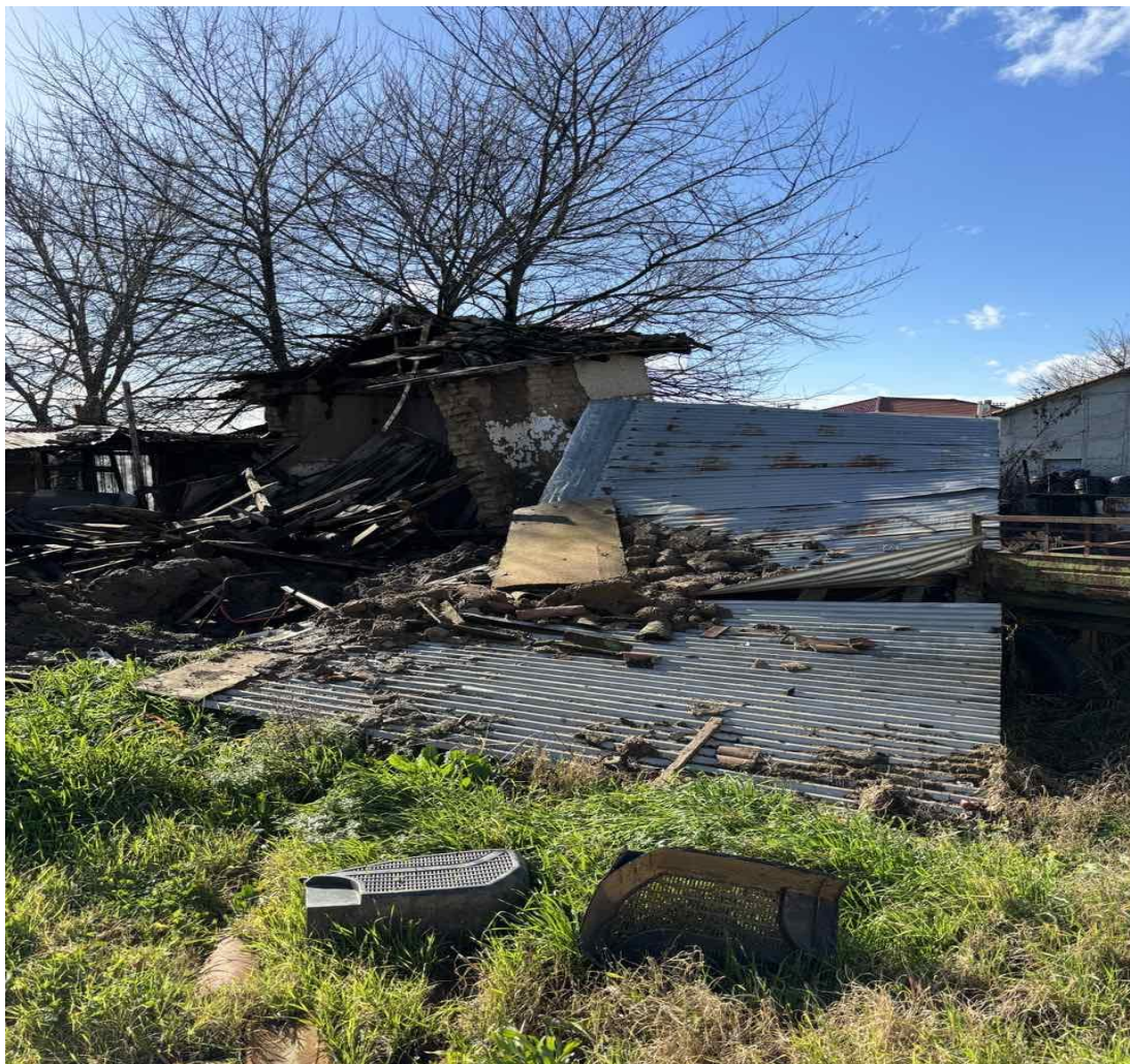
Εικόνα 9 :Μεγάλα Καλύβια Τρικάλων, αποθήκη επιχείρησης γκρεμίστηκε από τα ορμητικά νερά.
